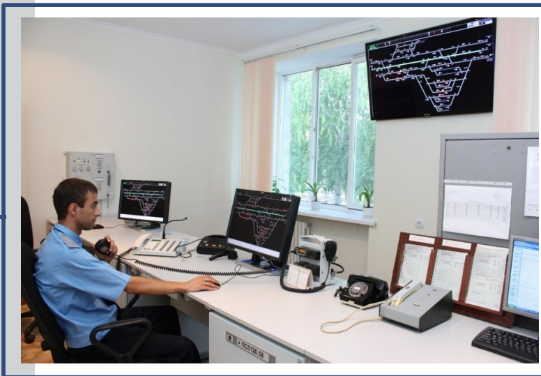
Робоче місце чергового по станції (АРМ ДСП)
